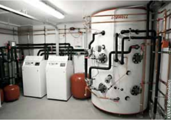
Maalämpöjärjestelmä, jossa on kaksi pumppua ja varaa- ja.
